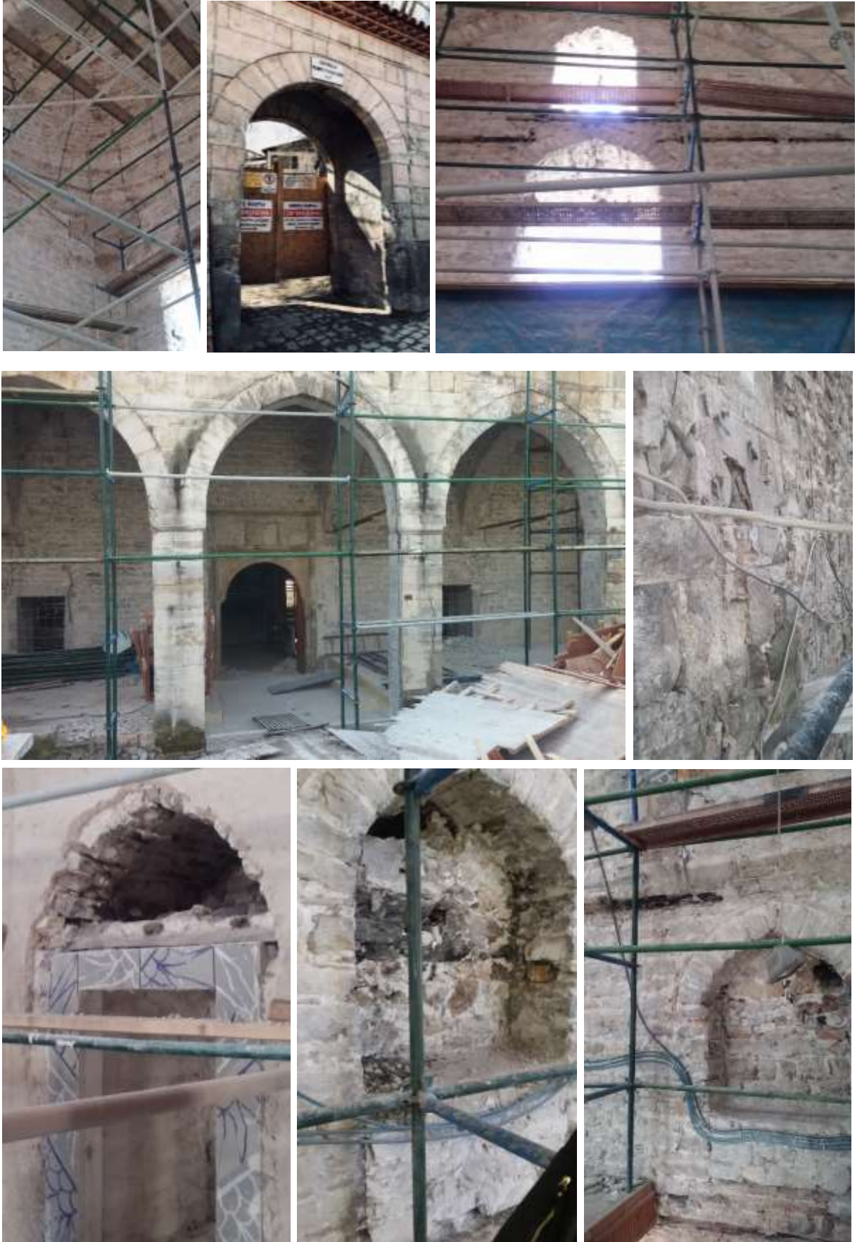
Şekil 4. Köprülü Mehmet Paşa Caminin restorasyon, bakım, onarım ve güçlendirme gerektiren kısımlarından bazı görüntüler
