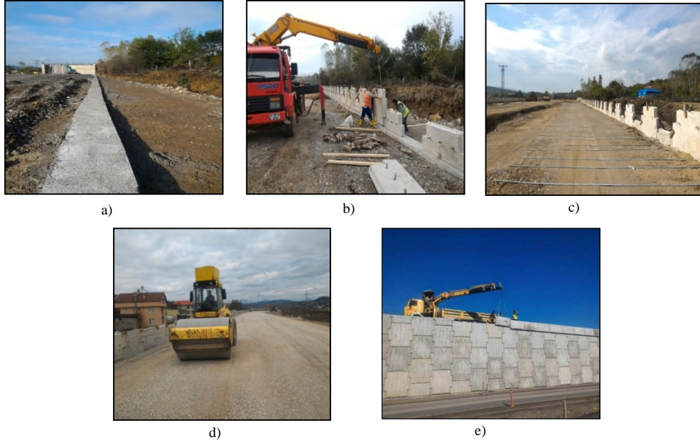
Şekil 2. Şerit donatılı toprakarme duvar imalat aşamaları; a) tesviye betonun dökülmesi b) prekast panellerin yerleştirilmesi c) çelik şeritlerinin montajı d) dolgunun sıkıştırılması e) harpuşa montajı
