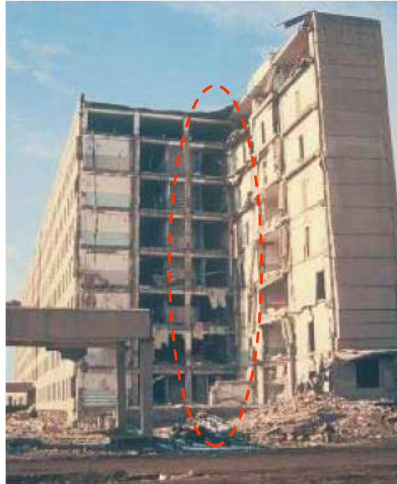
Deprem derzi olmayan L tipi yapı hasarı
