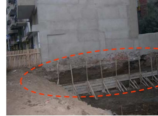
Temelsiz 5 katlı yapı
