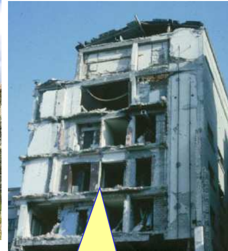
Depremde göçmüş balkonlar
