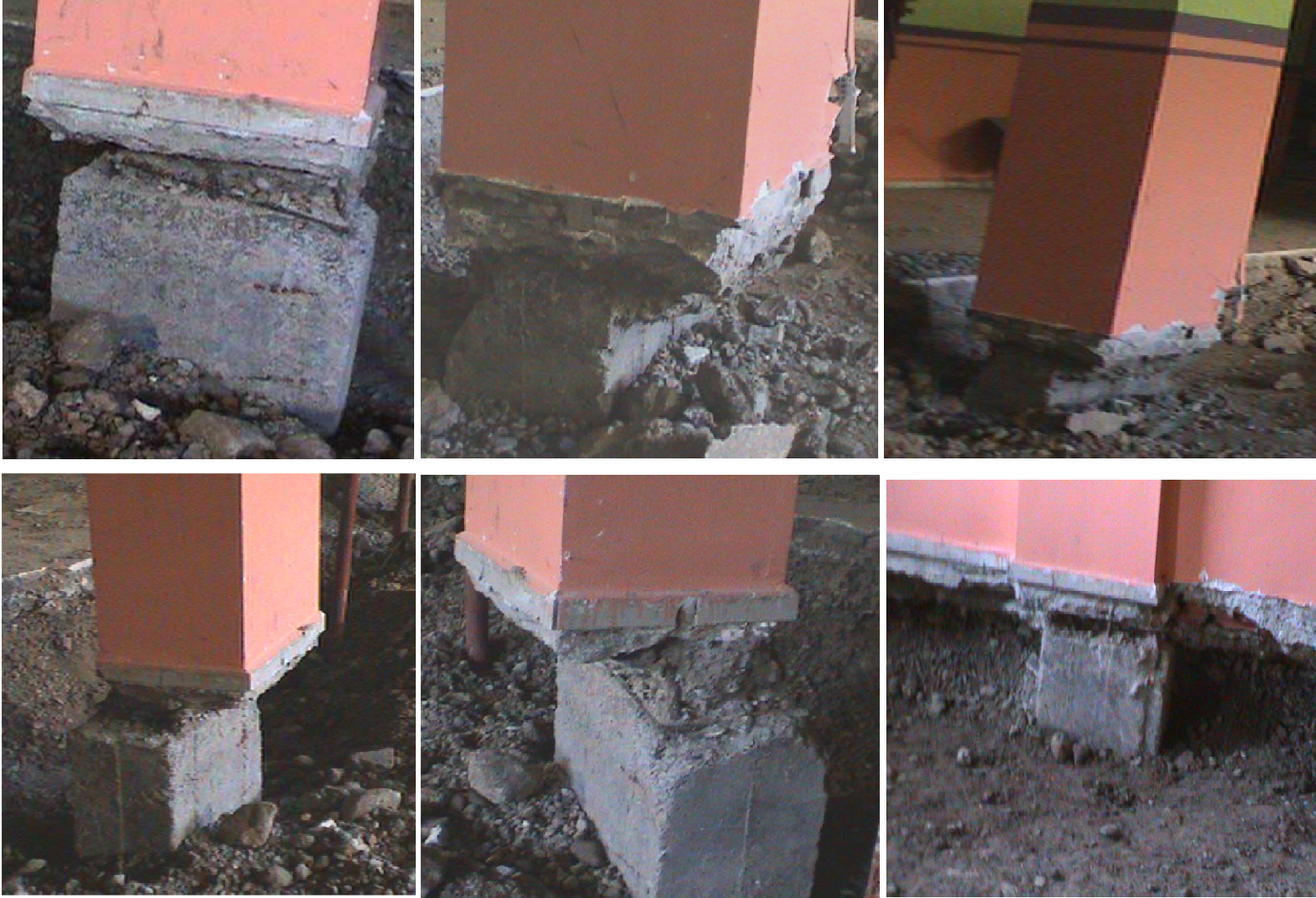
Mualla Zeyrek İlköğretim Okulunun temel üstü kolonları-ESKİŞEHİR, 2004
