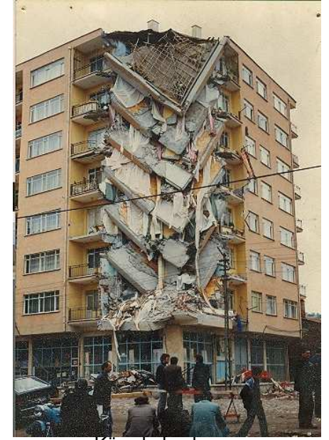
Köşe kolon hasarı
