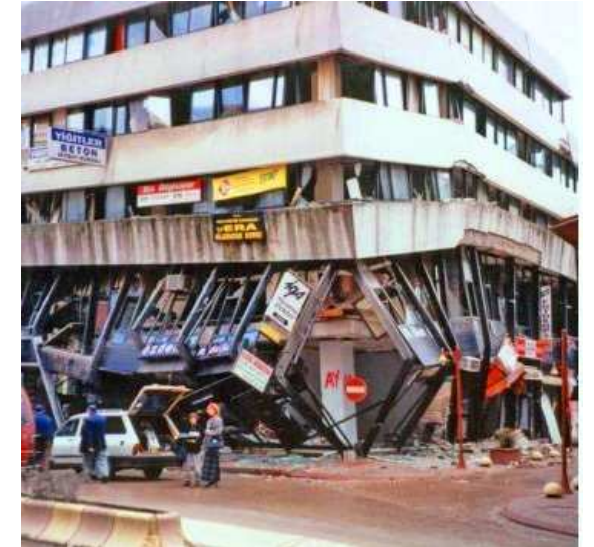
Köşe kolon hasarı
