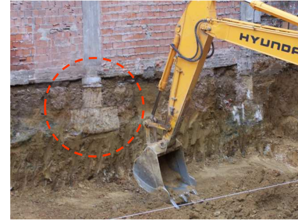
Yetersiz tekil temel (pabuç küçük, bağ kirişi yok!)
