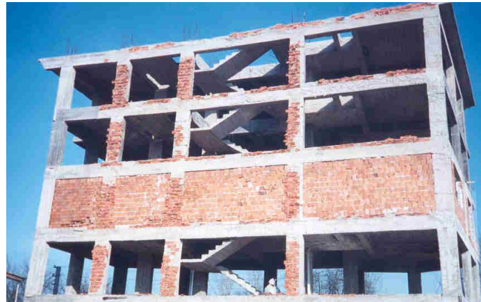
Sandviç duvarlar depremde devrilirler
