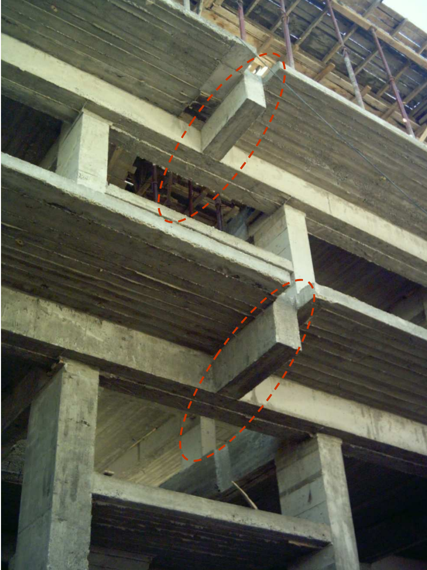
Yapı içinde devamı olmayan ve kirişe saplanan konsol burulmaya neden olur.
