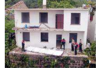
Göçmüş balkon. Usta balkon plağı altında cansız yatıyor.
